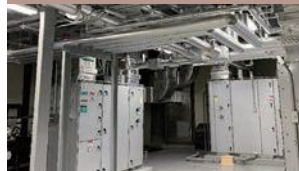
1階：空調機械室 空調機
