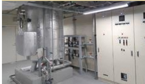
高層棟2階：給湯システム
