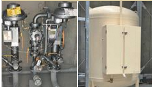
高層棟外部：ガス設備
