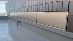
6階：バルコニー 自然換気窓
