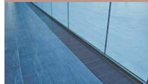
1階：エントランス床吹出空調
