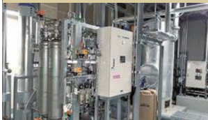
機械棟1階：ろ過装置
