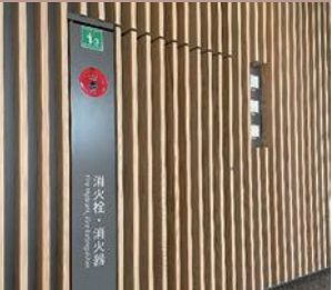
各階：屋内消火栓
