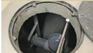
低層棟1階：災害用汚水貯留槽
