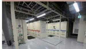
5階：電気室 受変電設備
