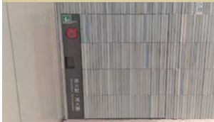
各階：屋内消火栓
